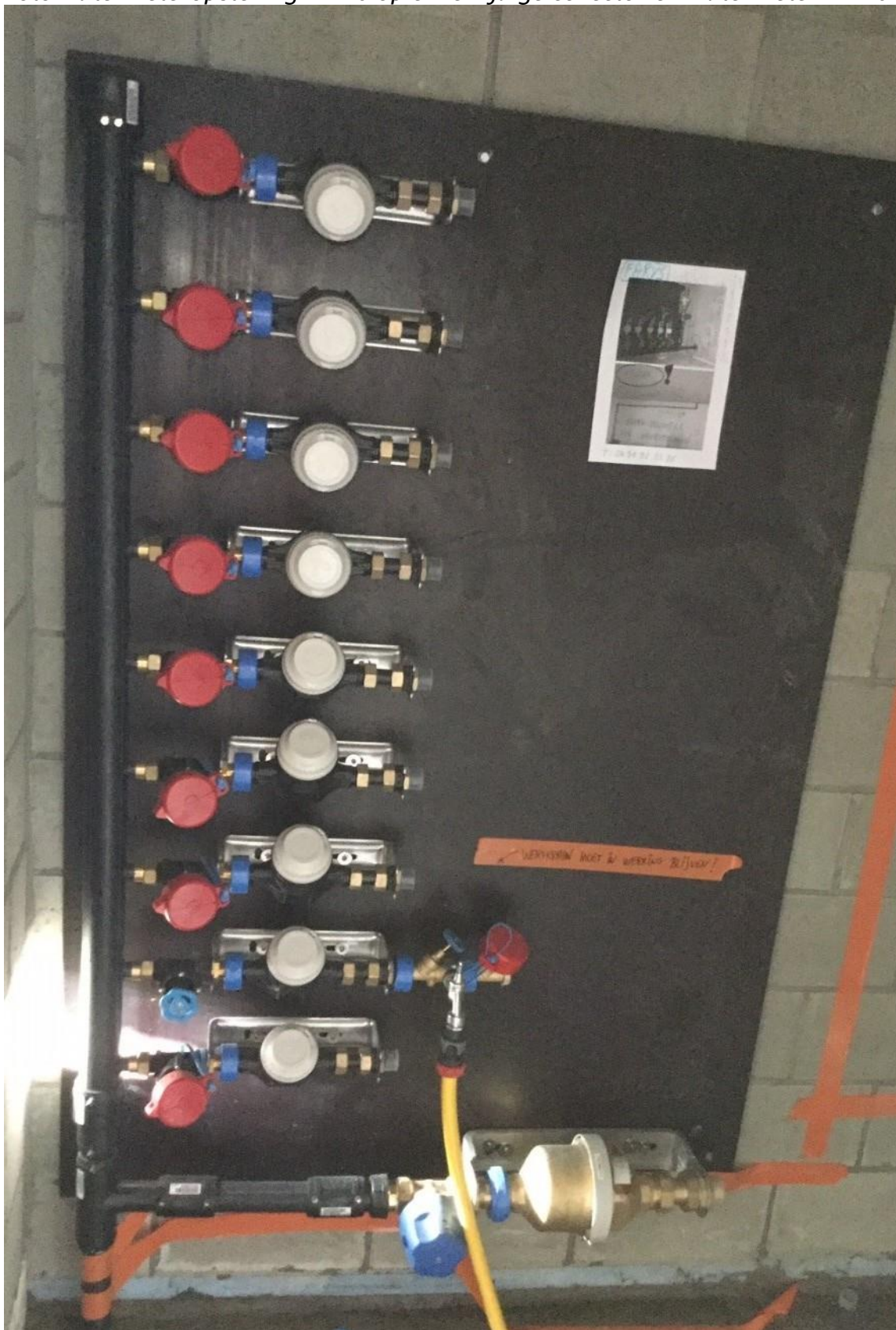
Foto watermeteropstelling DN20 op enkelzijdige collector en watermeter DN40
